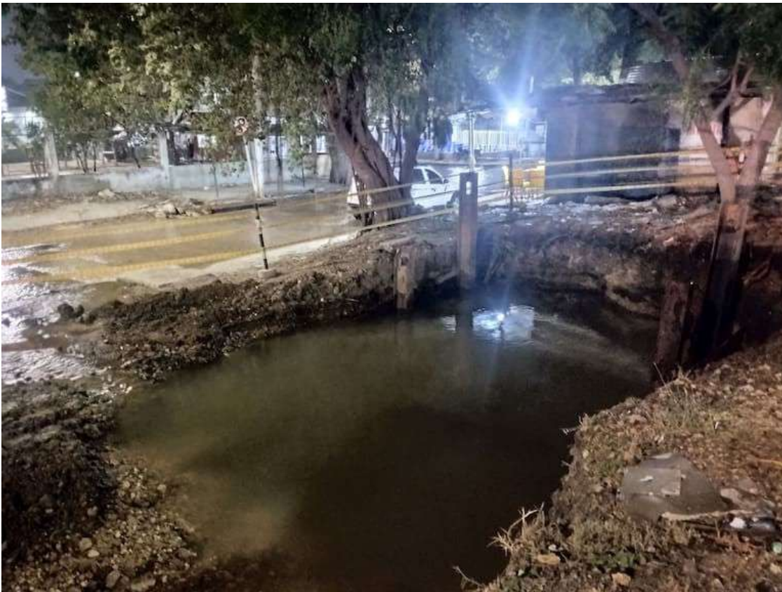
Acuacar hizo un cierre de válvulas para controlar la emergencia provocada por el tubo que se rompió en Santa Clara. // Foto: Óscar Díaz Acosta
