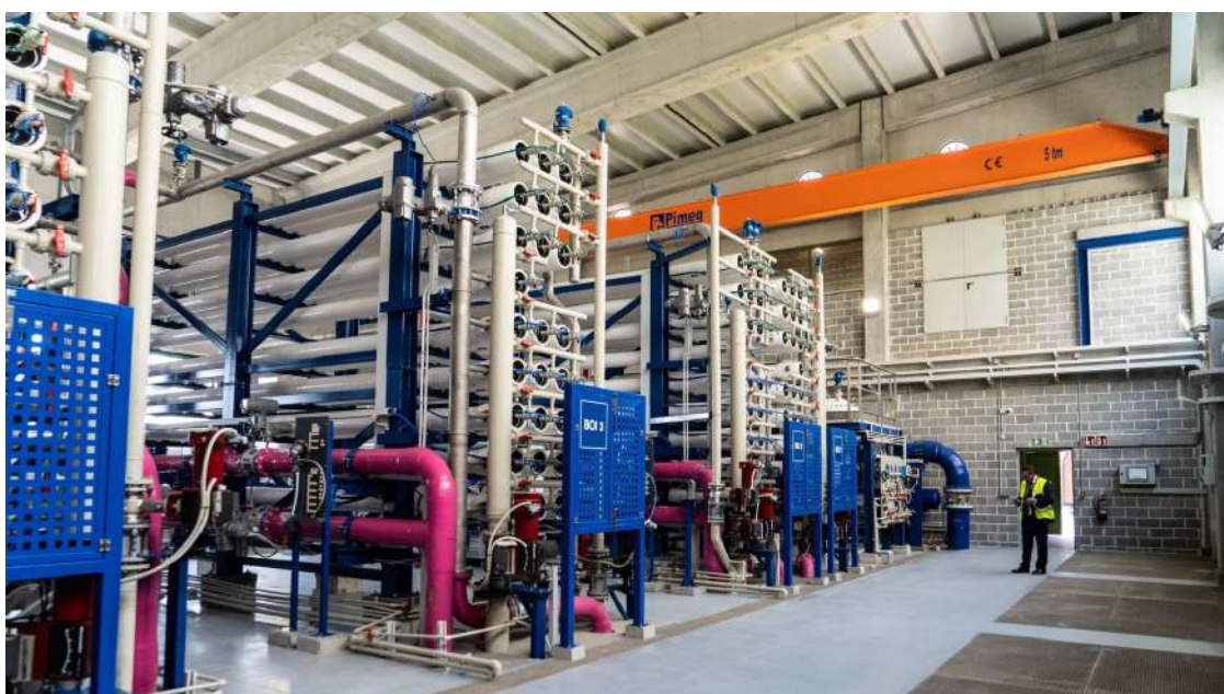
Veolia estrena la nueva potabilizadora de Sant Feliu
